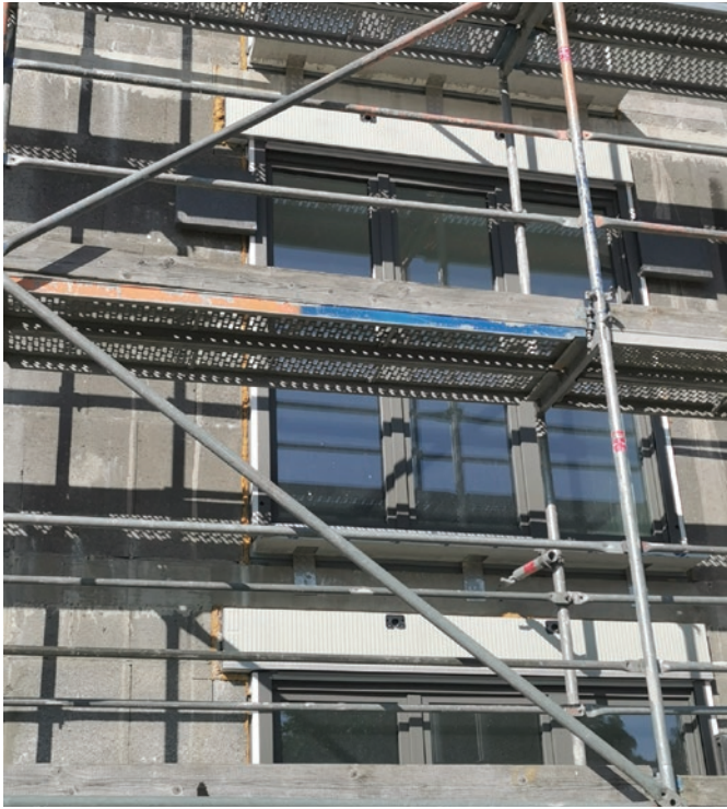
Bild 3 Bei der Umsetzung der Mehrgeschossbauten im Quartier „Weiler Höfe“ kamen großformatige Planelemente aus Leichtbeton von KLB Klimaleichtblock zum Einsatz.
