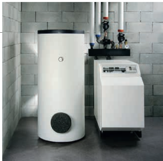
Bild 16: Anlagentechnik im Keller
